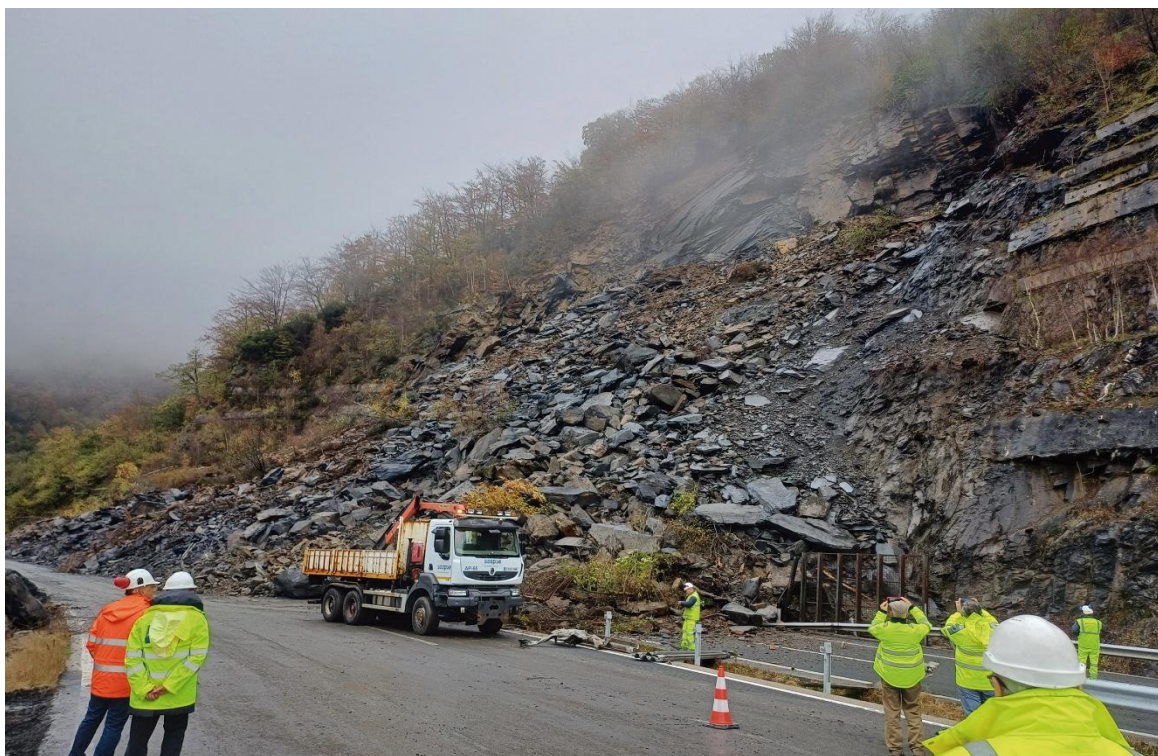
Desprendimiento de rocas en AP-66
